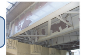
鋼橋の腐食の例
