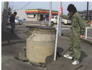
マンホールの浮上り
